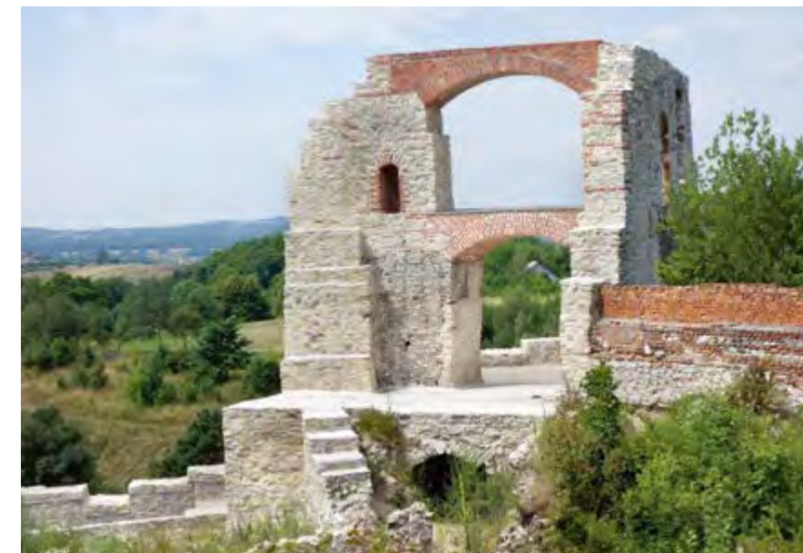
II. 3 Budynek północno-zachodni, zamek Tenczyn. Wprowadzone (inspirowane działaniami Zygmunta Hendl) łąki wiążące zagrożoną zawaleniem ścianę północną z bardziej stabilną częścią ruin, 2016 Fot. Jan Janczykowski
