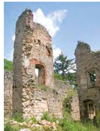
Il. 32 Zamek Cimburk koło Koryčan, fasada dziedzińcowa pałacu przed zabezpieczeniem zagrożonej upadkiem budowli, 2014
