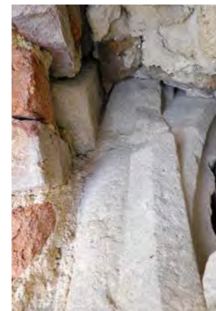
Il. 4 Detale łuków żeber kaplicy, zachowane w murze pomieszczenia, zamek Cimburk u Koryčan, 2018
