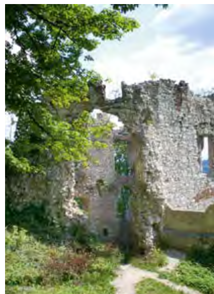
II. 2 Baszta Nawojowa, zamek Tenczyn. Obiekt w stanie katastrofy budowlanej (obecnie uratowany), 2009
