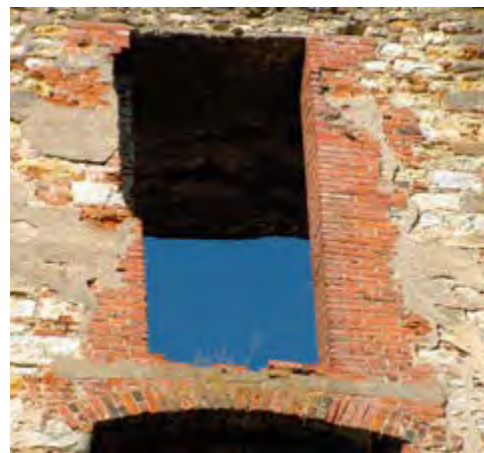
II. 23 Zamek Boskovice, ceglana okładzina kawern, zagrażająca stabilności muru, 2010
