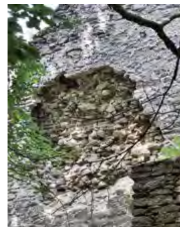
Il. 21 Zamek Choustník, uszkodzenie lica rdzenia zamku, 2022 Fot. Jiří Varhaník
