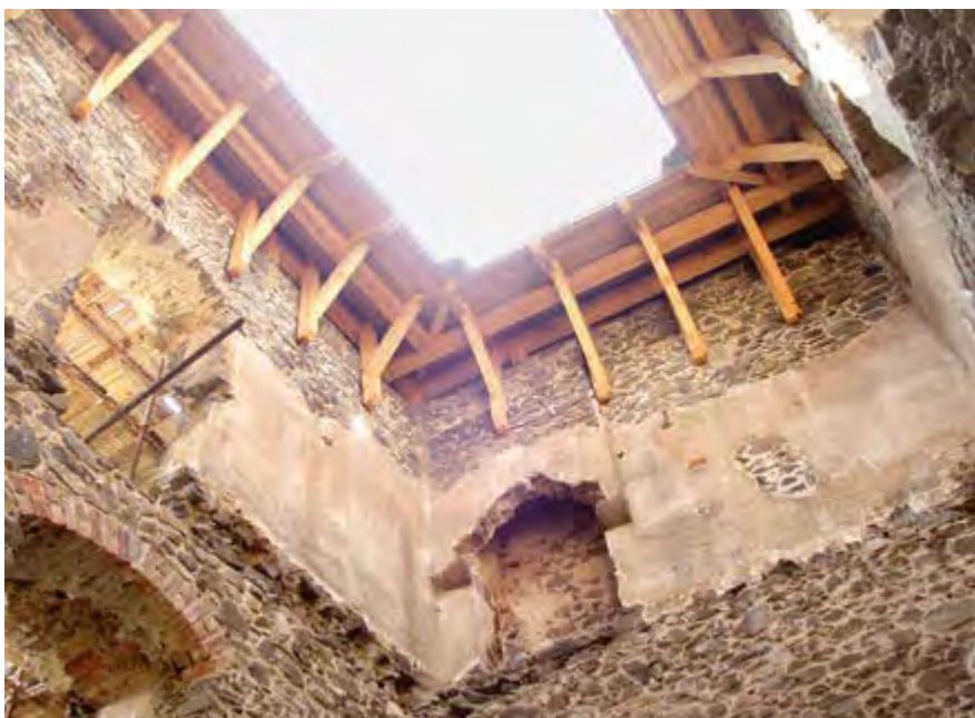
Il. 31 Pozostałości tynków wewnętrznych górnego pałacu przykryte daszkami, zamek Rokštejn, 2008
